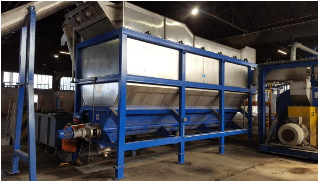
Bac de décantation flottation
