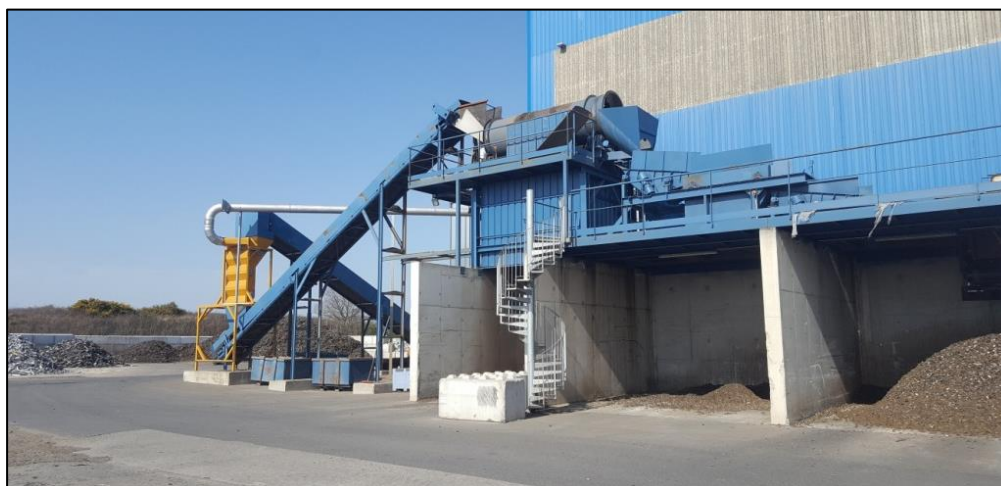
Ligne de tri n°1 mécanique : broyeur, aéro-séparateur, aimant, induction
