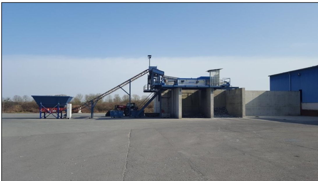
Ligne de tri mécanique n° 4 des déchets d'aluminium
